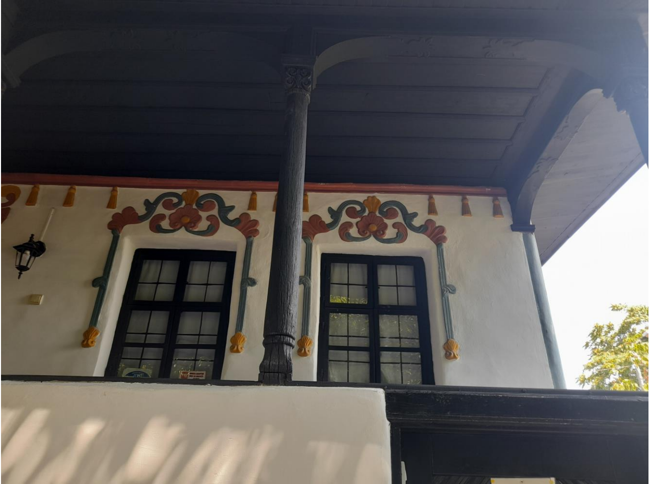
Fig. 15. Casa hagi Prodan, Ploiești. Detaliu fațadă pavidor: ferestre cu ancadrament decorativ din stuc policrom, cornișă cu ciucuri din stuc.
