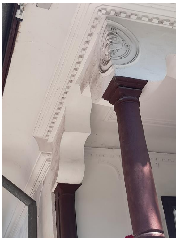
Fig. 13. Detaliu decorativ pe timpanele de colț ale antablamentului pridvorului: măști grotești antropomorfe, din stuc. Casa Dobrescu.
